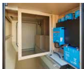
Garage con centrale elettrica
